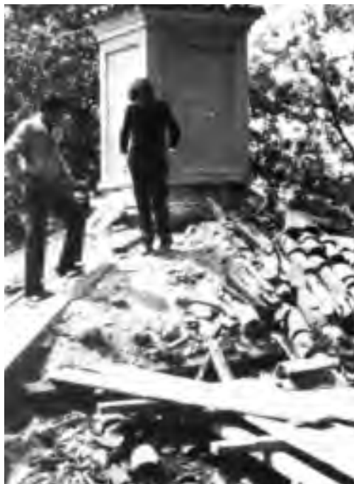
Iniziano i lavori alla cappella VII, sul tetto Liana Pittarello e l'impresario Longhi
